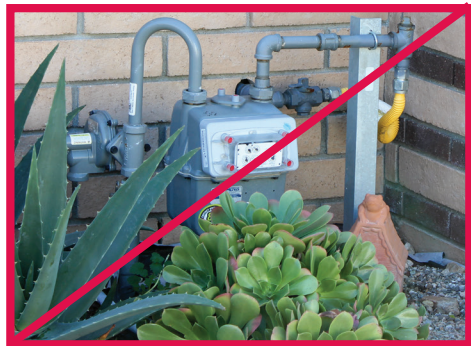
Espacio de trabajo inadecuado
